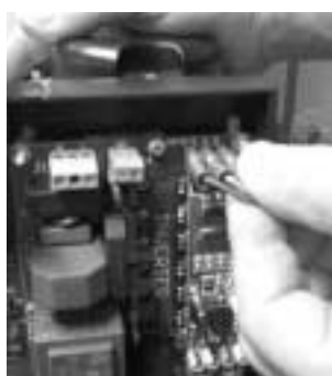
Câbles du moteur sur inverter
