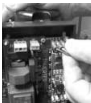
Cavi motore su inverter
