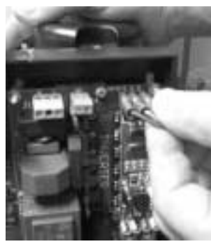
Motorkabel auf Inverter
