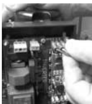
Câbles du moteur sur inverter
