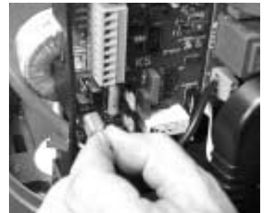
Entfernung der Motorkabel von dem KS
