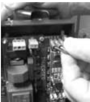
Motorkabel auf Inverter
